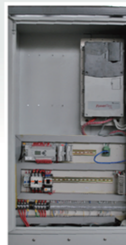
控制電箱 Control box
